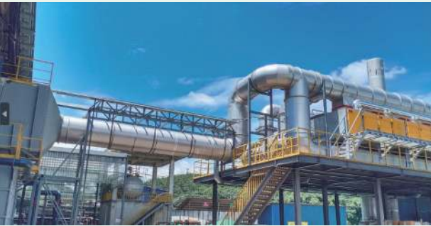
VOCs项目设施
